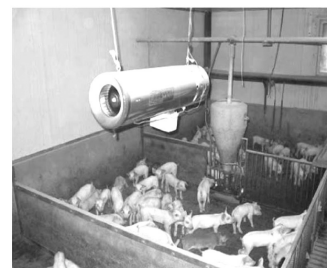
〈자돈사 내 먼지 제거기 설치〉
