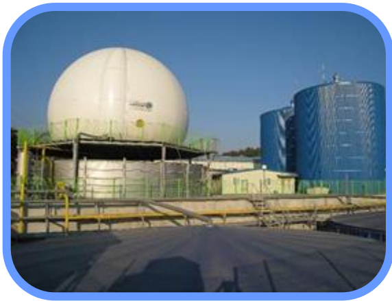
바이오가스 플랜트 전경
